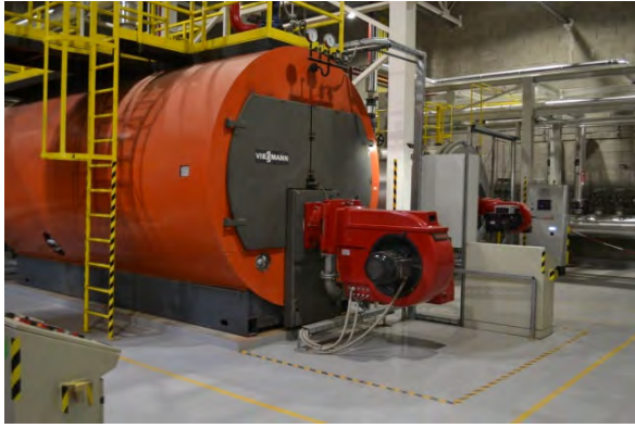
N010 teremben lévő kazánház
